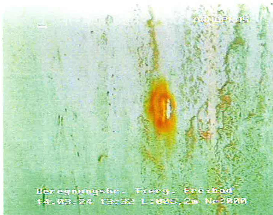
Bild Nr. 4 Tiefe: -5,2 m Im Aufsatzrohr, sehr geringe Ablagerungen an der Rohrwand, Blick auf Korrosionspunkt
