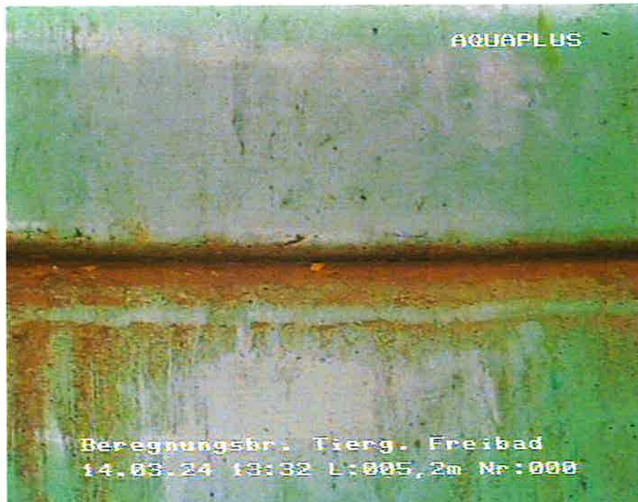
Bild Nr. 3 Tiefe: -5,2 m Im Aufsatzrohr, geringe Ablagerungen an der Rohrwand, Blick auf Rohrstoß
