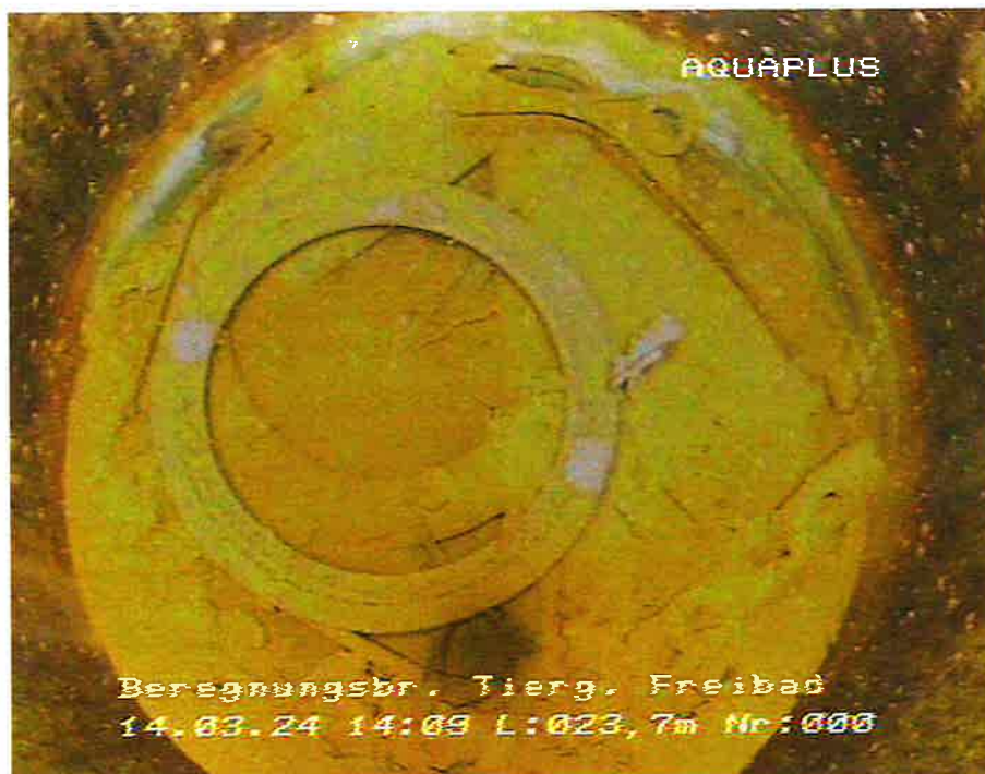
Bild Nr. 16 Im Sumpfrohr, geringe Ablagerungen an der Rohrwand, Blick auf den brunnengrund mit Fremdkörpern
