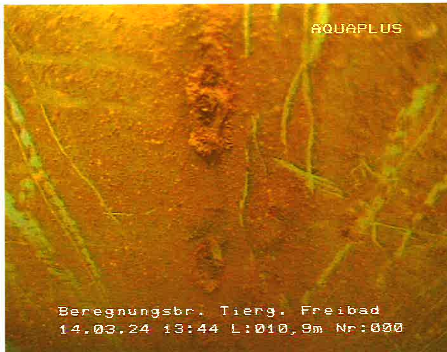
Bild Nr. 7 Im Aufsatzrohr, Ablagerungen an der Rohrwand
