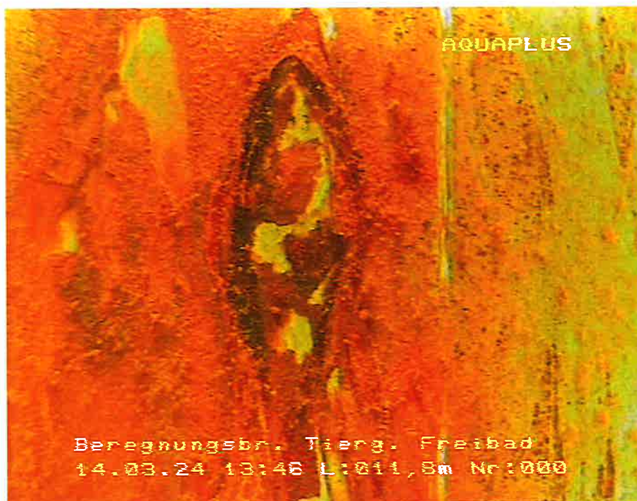
Bild Nr. 8 Im Aufsatzrohr, Ablagerungen an der Rohrwand
