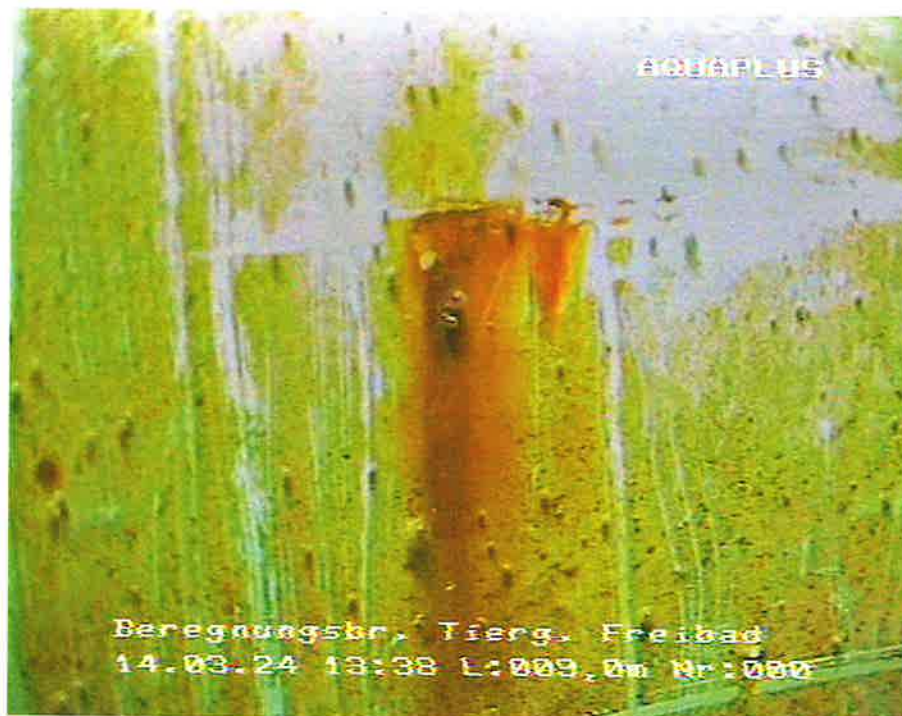
Bild Nr. 6 Tiefe: -9,0 m Im Aufsatzrohr, geringe Ablagerungen an der Rohrwand, Blick auf Korrosionsfahne
