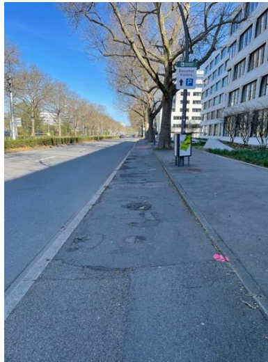
Abbildung 18 - Beispiel beschädigter Wegoberflächen
